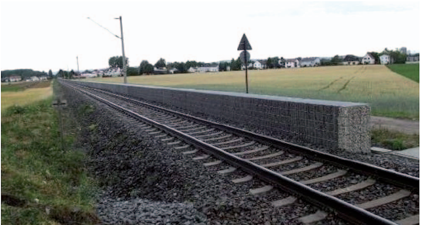
Lärmschutzgabionen Zufahrtsgleis Kombiverkehrsterminal BASF
