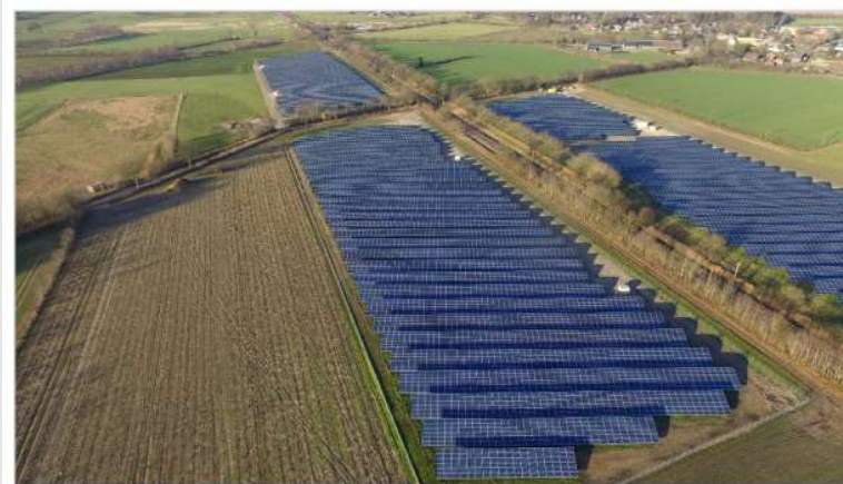
Abbildung 18: Photovoltaik-Freiflächenanlage entlang einer Eisenbahnstrecke (© F. Steinmann, LLUR)
