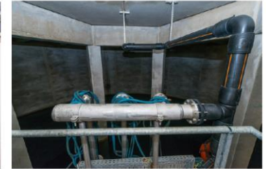
Zisterne zur Regenwassernutzung, Olympiastadion Berlin (Foto: Andreas Süß)
