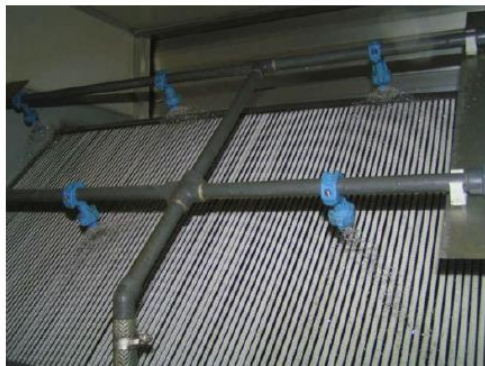
Adiabate Abluftkühlung, Institut für Physik der HU Berlin, Adlershof (Foto: M. Schmidt)
